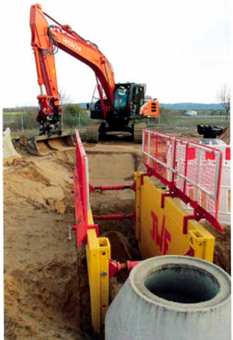
Böschungen aufbauen: Besucher der „Expo Kanalbau“ im Coreum dürfen selbst Hand anlegen. (Foto: Kiesel)
